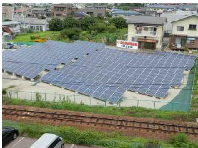
太陽光発電 平成25年5月から稼働
